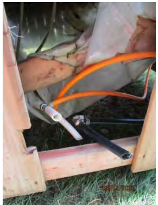
IMG_0006.JPG Photo 6. Tuyauterie sous le bloc sanitaire près du lac non connecté aux aqueducs et aux égouts
